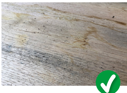
Tâches d'eau séchées sur une face
